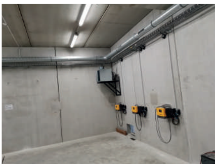
Locaux de charge
